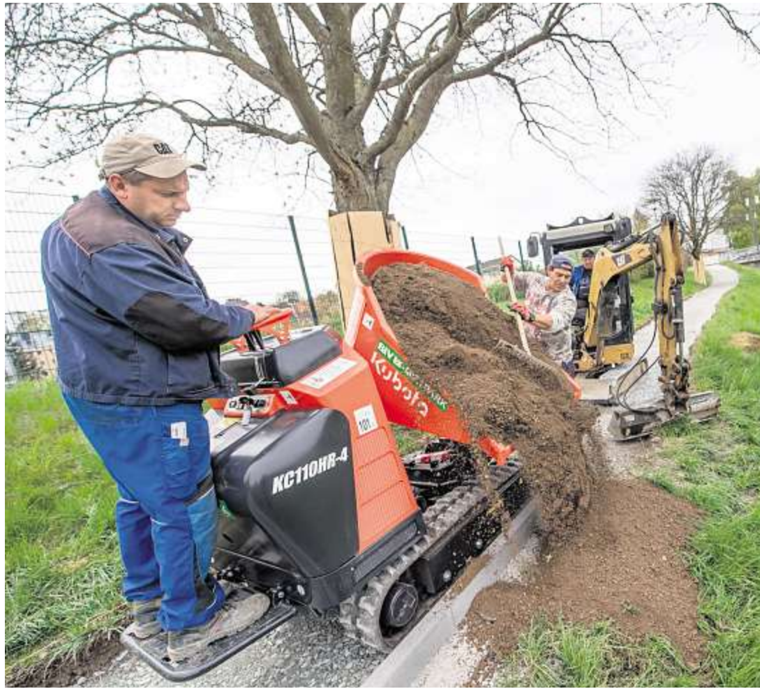
Noch bis Ende kommender Woche laufen die Arbeiten am Geh- und Radweg entlang der Saale an der Lessingbrücke in Hof. Dabei bauen die Arbeiter der Firma Sinnig aus Münchenberg im Auftrag der Stadt Hof auf etwa 200 Metern Länge den ehemaligen Trampelpfad mit Schotter aus. Foto: Jochen Bake
